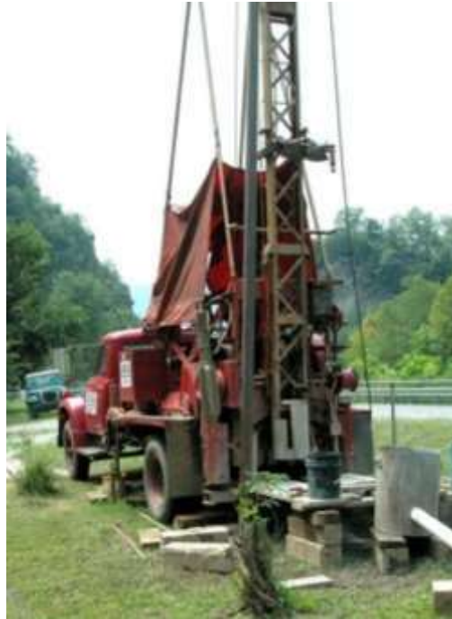
Fig. 5.1a Cable Tool Rig
